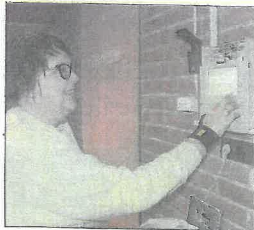
NYTT SYSTEM: Kirketjener Marit Maurud viser fram kontrollpanelet for det nye helautomatiserte digitale systemet, som styrer kirkeklokkene, og som ble installert før sommeren. Det er etter alle solemerker en feil i dette systemet eller elektronikken som gjør at kirkeklokkene har ringt ukontrollert.
